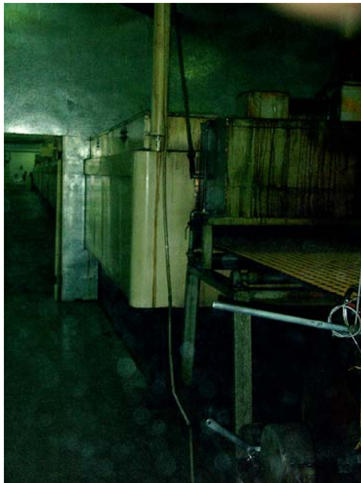
图 2-3 实际运行设备图
