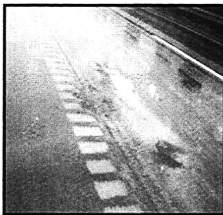
图 2-6 位于行车道上的松散和坑槽
