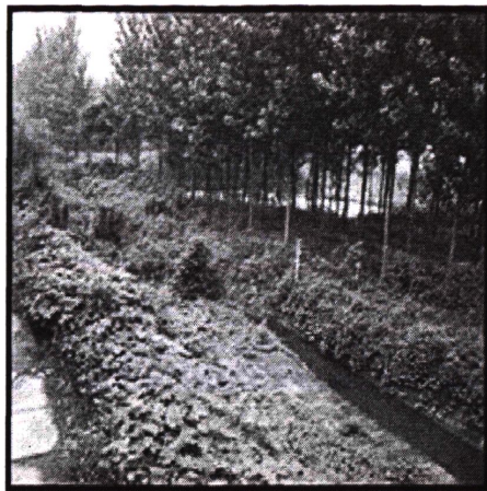
图 2-13 路基旁的积水边沟
