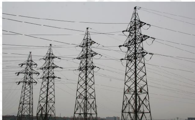
高压输电线路铁塔
